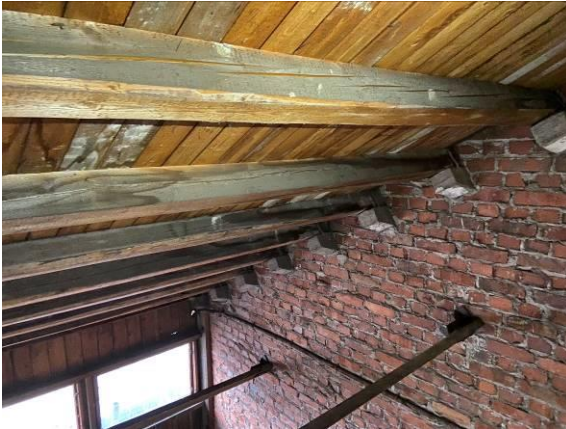
C-halli: orsien halkeilua, betonikonsolit muurauksessa
