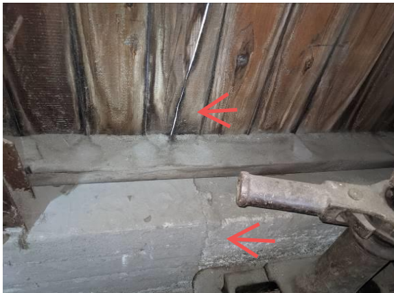
B-talo: sokkelin (perustuksien) halkeama jatkuu ulkoseinään
