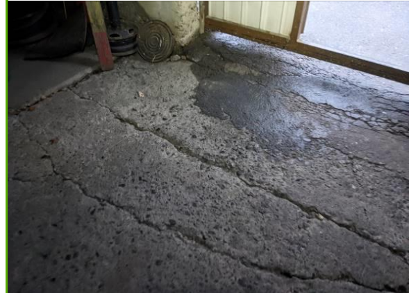
B-varasto: oven edustalla voimakasta asfaltin ja betonin halkeilua
