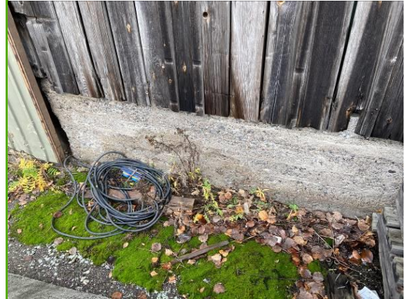
C-talo, etelä: asfaltissa sammalkasvustoa
