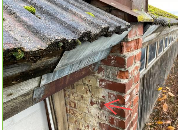
C-talo, itä: tiilimuurauksessa suurempi halkeama, tiiliä rapautunut, maalipinnoite kulunut
