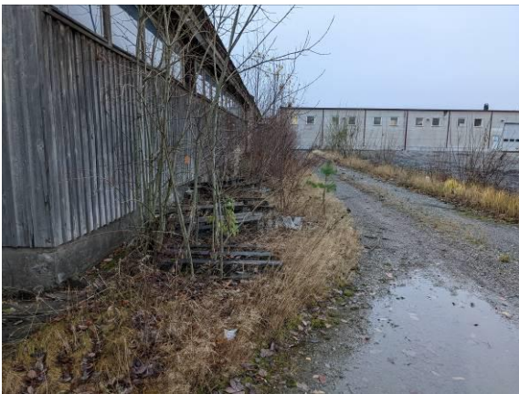
B-varasto, länsi: varasto hieman montussa, hoitamaton kasvillisuutta ympärillä
