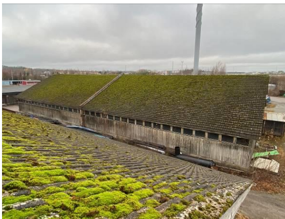
Yleiskuva vesikatoista, B-varasto vastapäätä, tiilikate sammaloitunut
