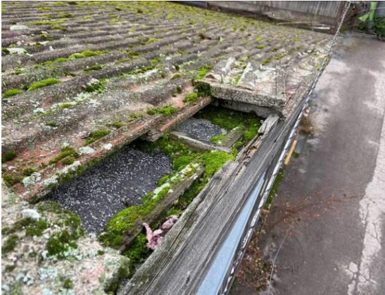
B-halli, eteläpääty: tiiliä puuttuu, alusrakenteet alkaneet vaurioitumaan
