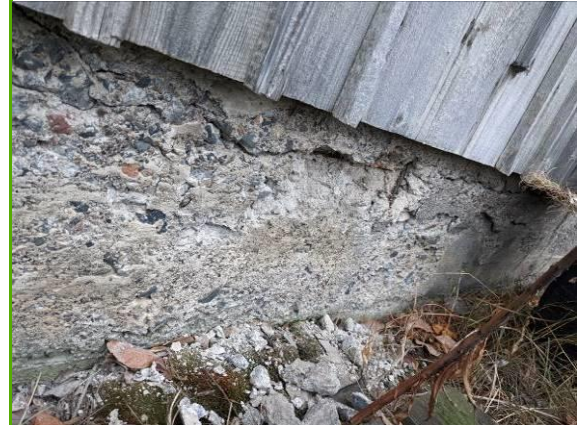
B-varasto, länsi: sokkeli rapautunut pitkälle ylä-osasta alkaen, ruostuneita teräksiä
