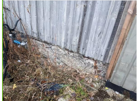
C-talo, pohjoinen: betoni rapautunut pitkälle, ruostuneita teräksiä pinnalla
