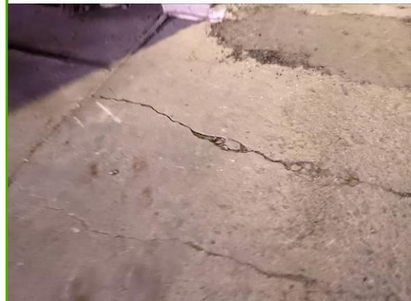
B-varasto: alapohja halkeillut ja lohkeillut, jälkivalu tehty korkerojen vuoksi
