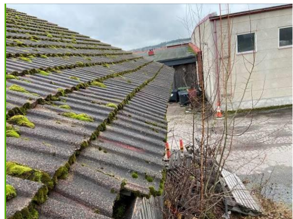
B-halli, länsisivu: räystäällä liikettä, katteen ja alustan vaurioita
