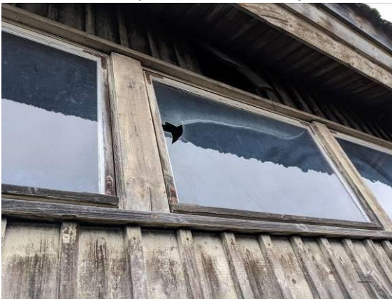
C-varasto: rikkoutunut lasi, ikkunoiden puuosien kunto parempi yläosissa
