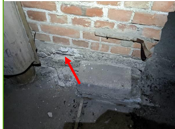
B-halli: tiiliväliseinän perustukset alkaneet rapautumaan, ruostunut teräs pinnalla
