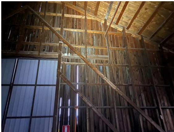
B-varasto, etelä: valo näkyy julkisivusta läpi, vesivuotojälkiä etenkin saumoissa
