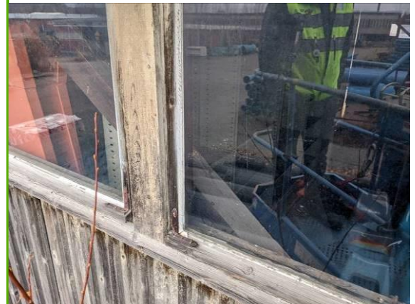
C-varasto: lasituskittauksia tippunut, kulmaraudat ruostuneet, maalipinnoite ehjänä välitilassa ylöspäin mentäessä
