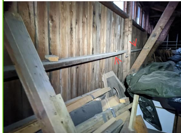
C-talo, itä: ulkoseinän vaakapalkit vääntyneet
