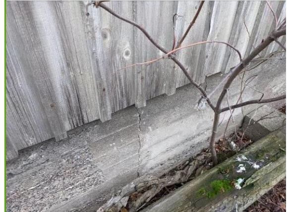
Halkeama kehän kohdalla, betonin pinta eh-jempi
