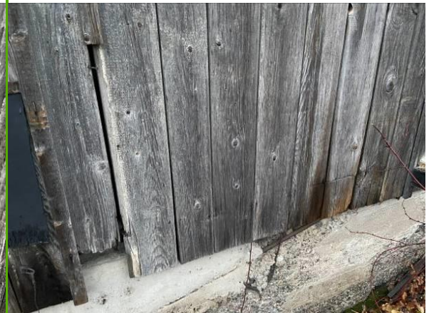
B-varasto, etelä: useita rimoja puuttuu, lautoja rikkoutunut
