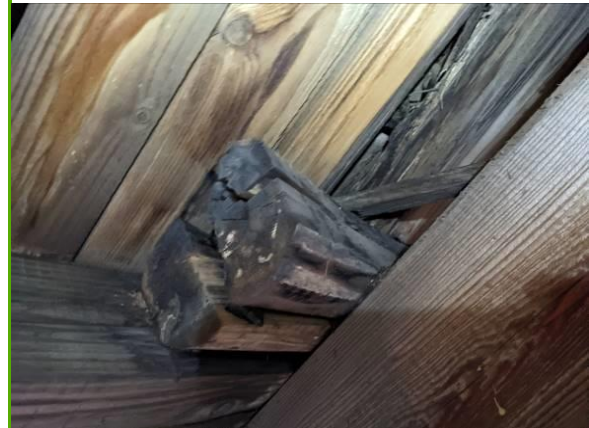
C-halli: orsia ja ruodelautoja lahonnut vesivuodoista
