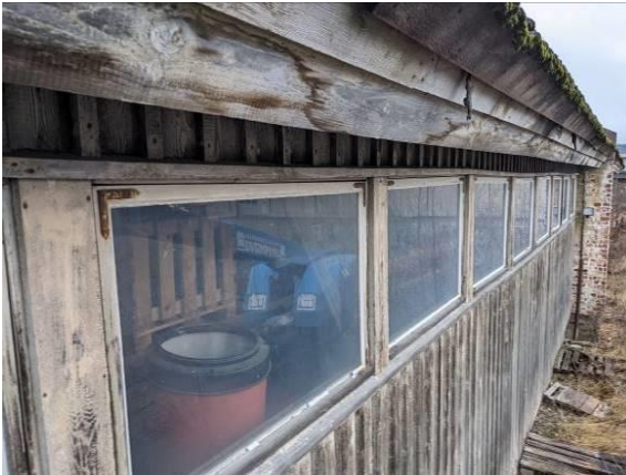
B-varasto: yleiskuva ikkunoista ulkopuolelta, ikkunariveissä muodonmuutoksia
