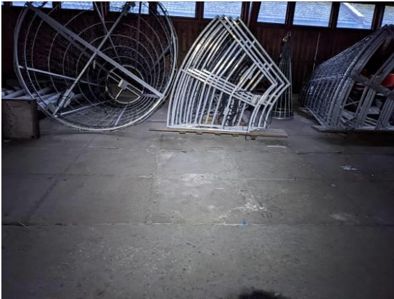
C-varasto: reunalaattojen halkeilu ja kulumista, kalkkihärmää
