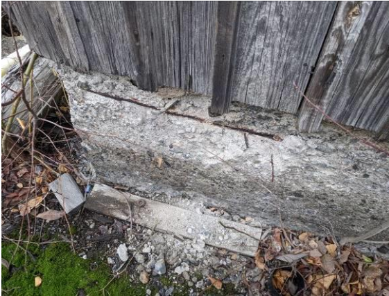
C-varasto, etelä: sokkelin kiviaines irtoaa vasa-roidessa rapautumisen seurauksena
