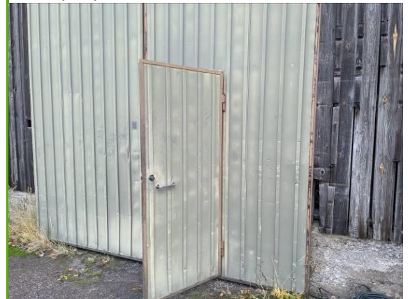
Ulko-oven rungossa ruostetta, ovi lähes kiinni maan tasossa
