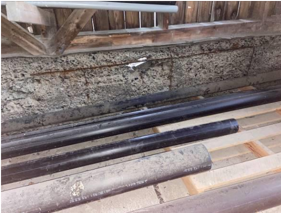
B-varasto, etelä: sokkeli rapautunut läpi, ruostuneita teräksiä sisäpinnalla
