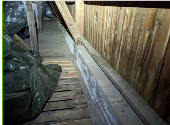
Sokkelissa voimakasta kalkkihärmää
