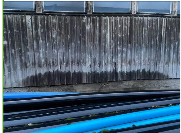
B-varasto, itä: kattovedet kastelevat julkisivujen alaosa
