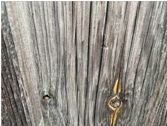
B-varasto, eteläpääty: julkisivulaudoituksen halkeilu voimakasta
