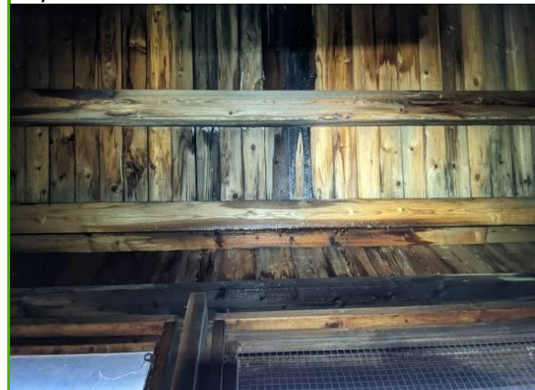
B-halli: vesivuotojälkiä sisäpinnoilla, vuodot kas- televat ulkoseinää
