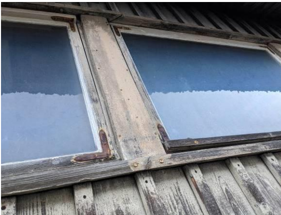
C-varasto: Lasikittaukset kovettuneet ja kuluneet, kulmaraudat ruostuneet, ikkunat tummuneet alaosasta, puu harmaantunut ja halkeilee
