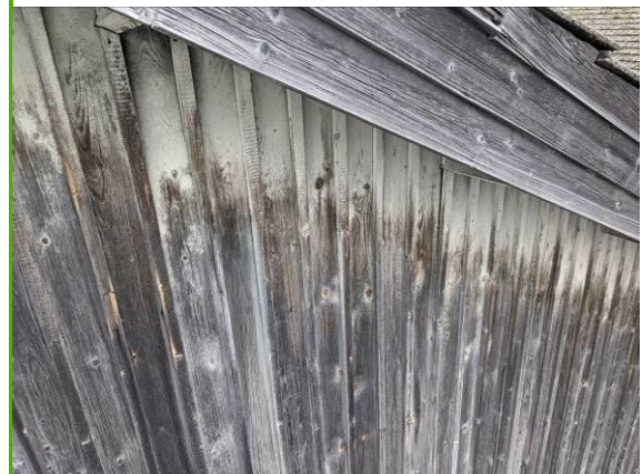
Maalipinnoite säilynyt ehjempänä räystääiden alta
