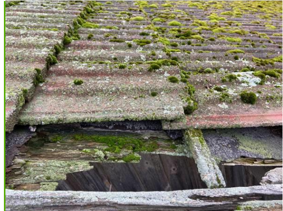
C-talo, etelä: tiiliä puuttuu B-varaston tapaan, räystääs lahonnut
