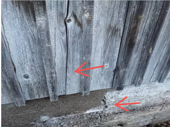
B-talo: sokkelin halkeama jatkuu julkisivuun rikkoen laudan
